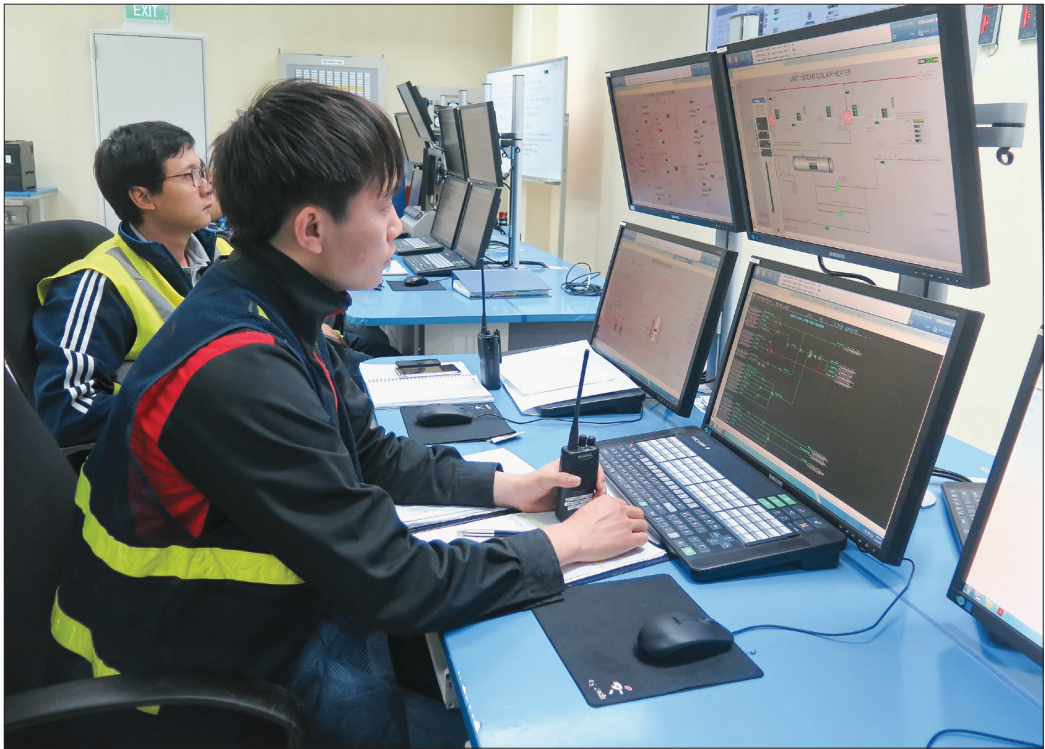
Trung tâm điều khiển hệ thống điện đã sẵn sàng cho việc vận hành thương mại tổ máy số 1.
