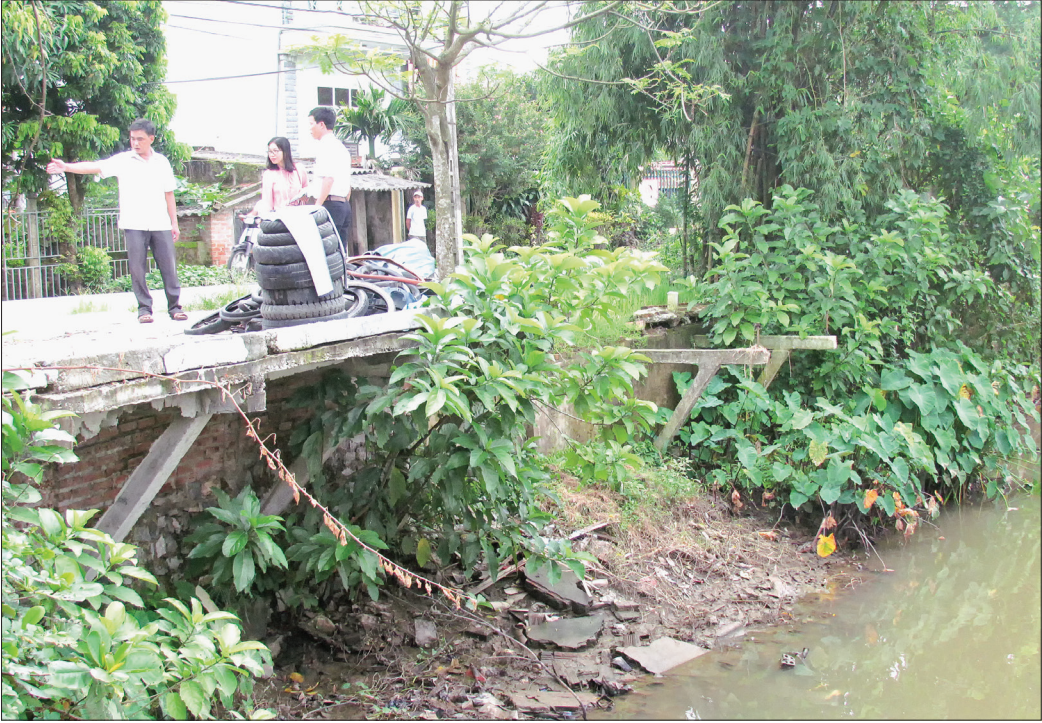
Móng nền công trình vi phạm hành lang bảo vệ công trình thủy lợi chưa được giải tỏa tại xã Văn Lang (Hưng Hà).
