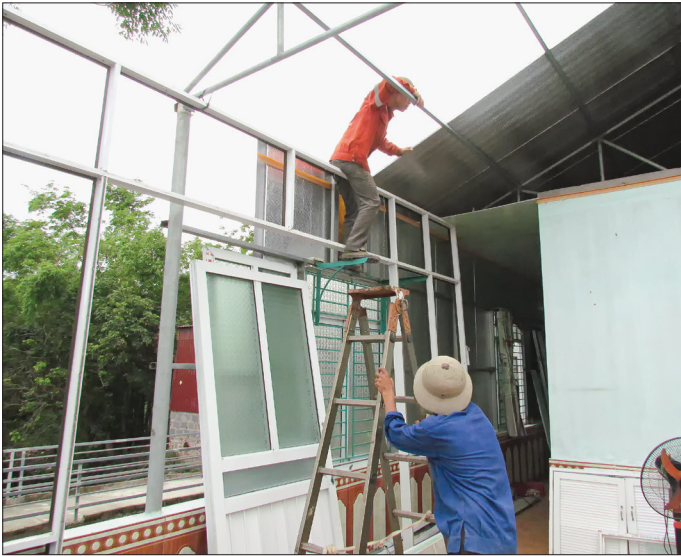
Ngôi nhà xây dựng trái phép trong phạm vi hành lang bảo vệ công trình thủy lợi được người dân tự nguyện tháo dỡ.
