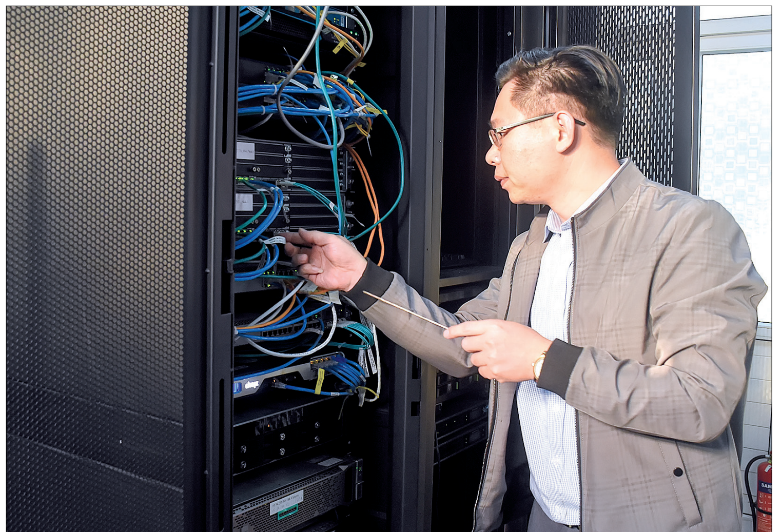
Cán bộ Phòng Công nghệ thông tin, BHXH tỉnh thường xuyên kiểm tra hệ thống thiết bị công nghệ thông tin.
