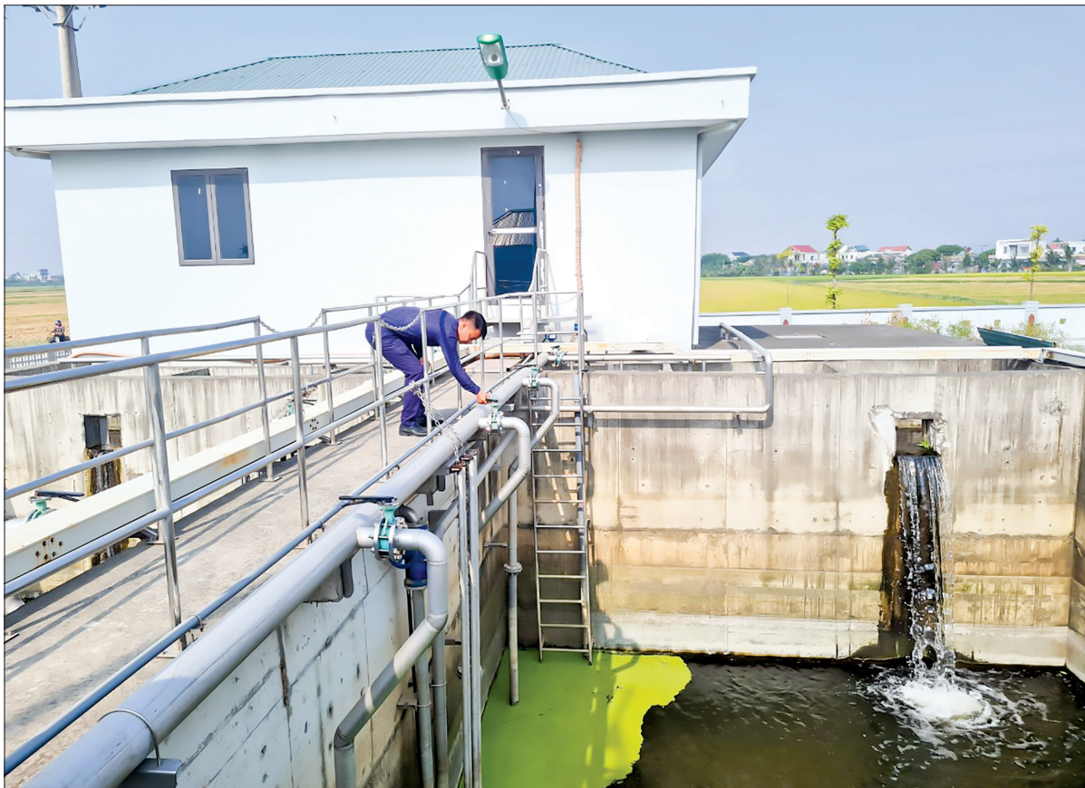
Trạm xử lý nước thải cụm công nghiệp Đồng La (Đồng Hưng) công suất 800m³/ngày đêm.
