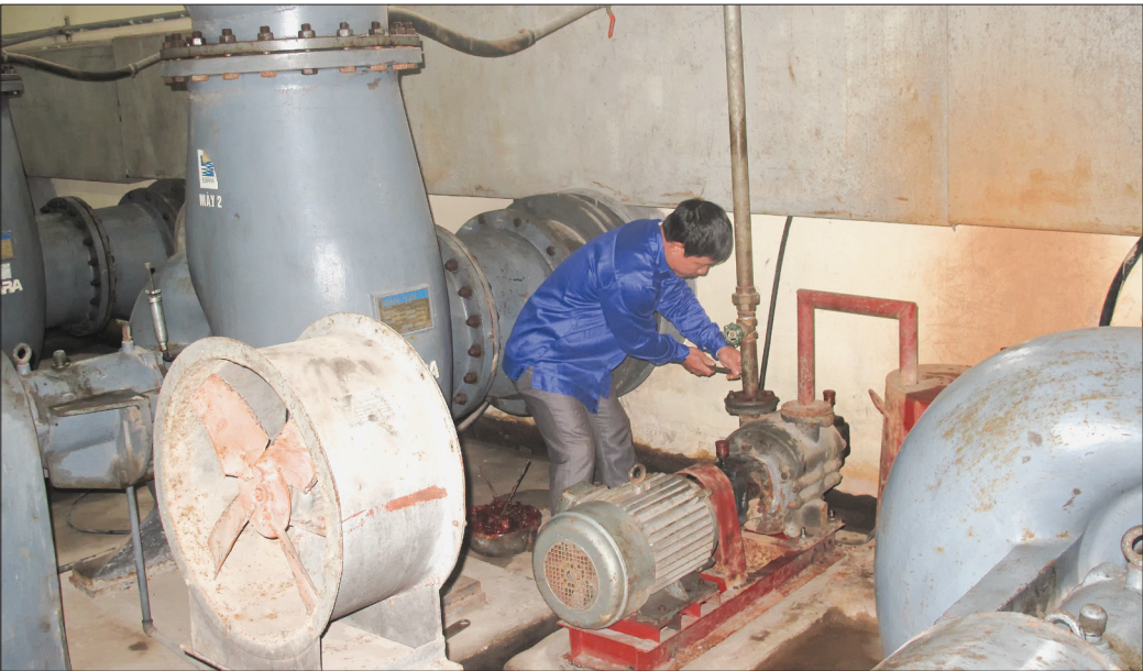
Công nhân Trạm bơm Thống Nhất (Tiền Hải) kiểm tra máy bơm chuẩn bị phục vụ tưới, tiêu vụ mùa.
