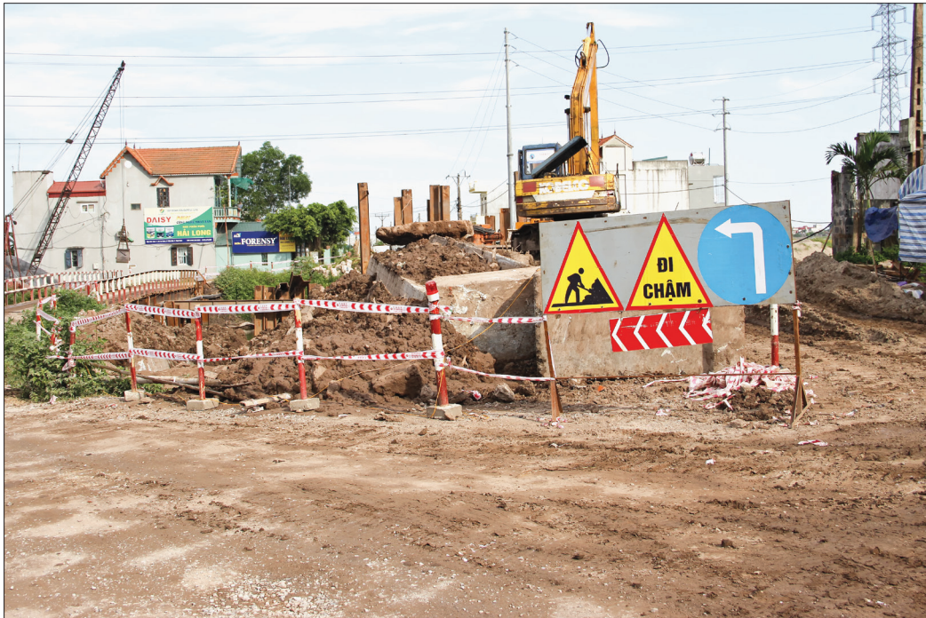
Hệ thống biển báo hiệu, cọc tiêu được nhà thầu thi công cầu Trạm Xá (xã An Ninh, huyện Tiền Hải) bố trí để người tham gia giao thông qua cầu tạm bảo đảm an toàn.
