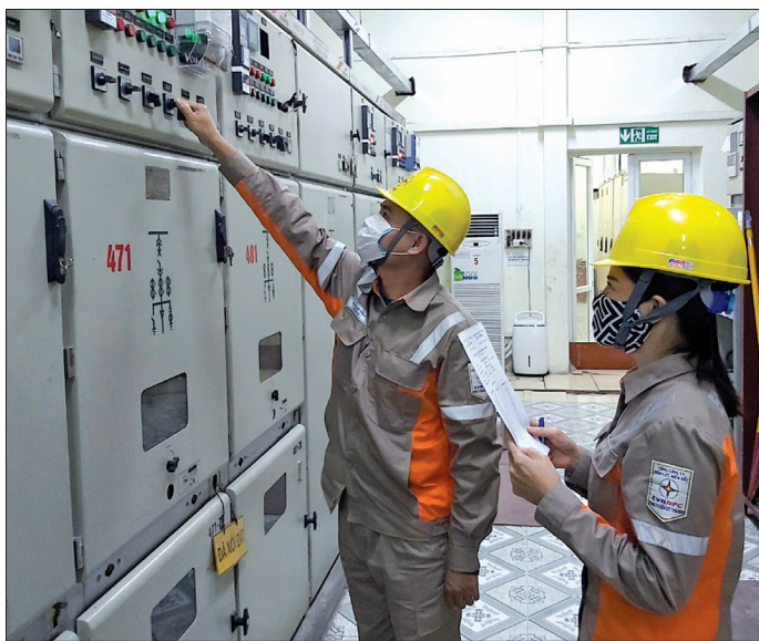
Đội quản lý vận hành lưới điện 110kV kiểm tra thông số kỹ thuật.
