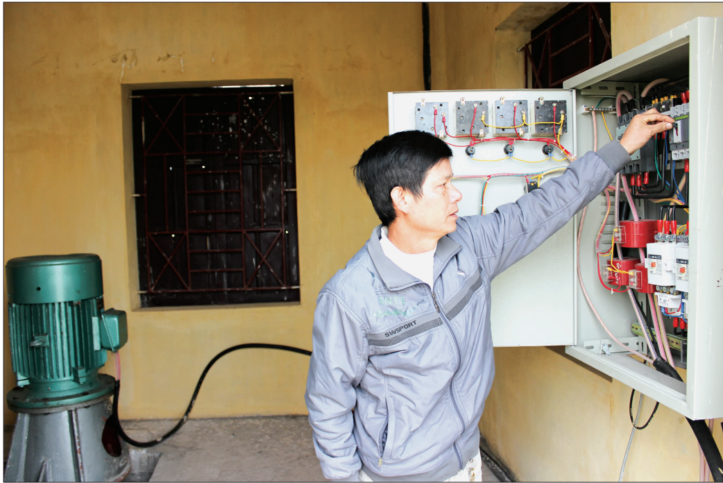
HTX SXKD DVNN xã Vân Trường (Tiền Hải) kiểm tra các trạm bơm sẵn sàng cấp nước cho việc đổ ải vụ xuân.
