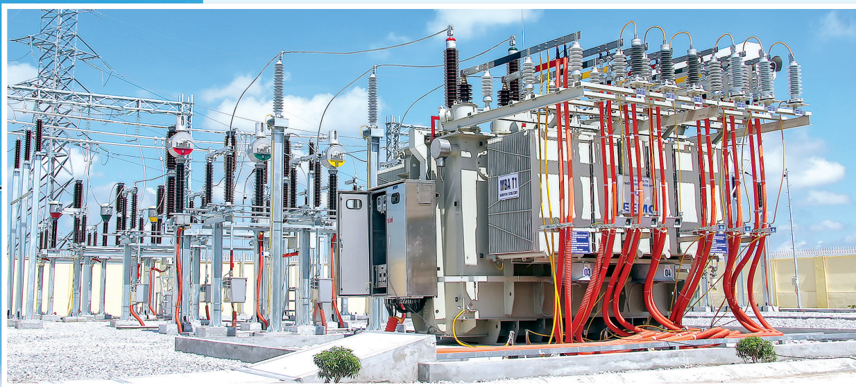
Công ty Điện lực Thái Bình từng bước đầu tư hiện đại hóa.
