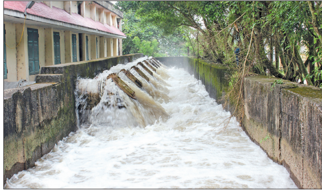
Trạm bơm Thống Nhất bơm nước phục vụ sản xuất.
