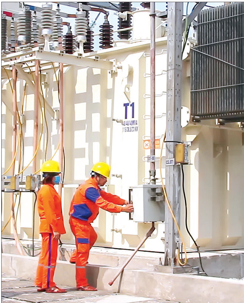
Công ty Điện lực Thái Bình đầu tư cơ sở vật chất bảo đảm cấp điện ổn định, an toàn.
