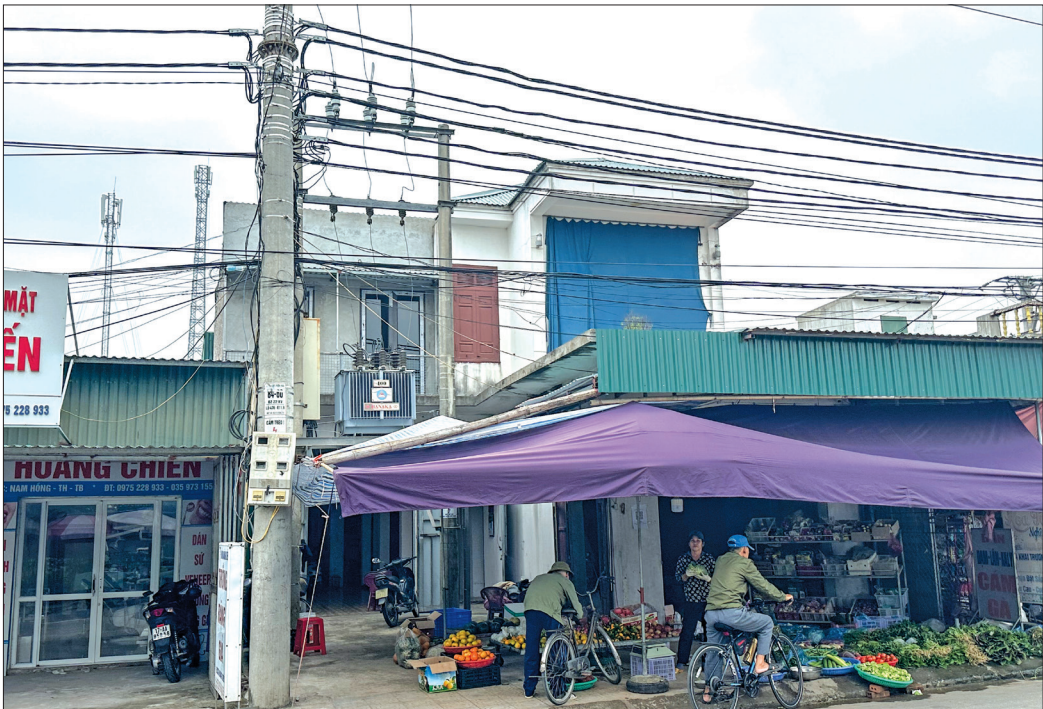
Khu vực đất trạm biển áp số 3 xã Nam Hồng bị lấn chiếm để xây dựng nhà ở và làm nơi bán hàng.
