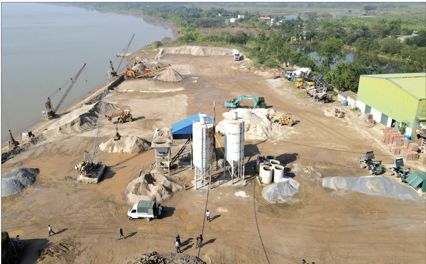
Trạm trộn bê tông trái phép tại xã Việt Thuận trước khi bị tháo dỡ.
