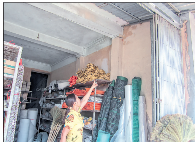
Xe trọng tải lớn chạy trên đường tỉnh lộ 454 làm nhiều mái nhà, tường nhà của hộ dân nằm ven đường bị nứt.
