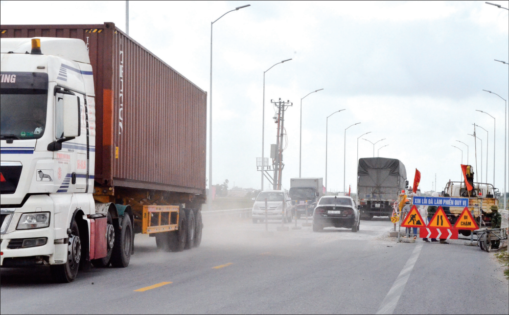
Ô nhiễm môi trường từ thi công đường giao thông.
