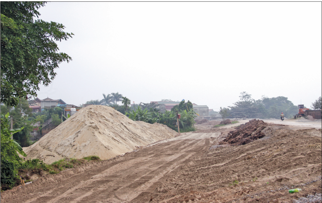
Bãi tập kết vật liệu xây dựng vi phạm hành lang bảo vệ đề mới được Hạt Quản lý đề điều huyện Đông Hưng phối hợp với UBND xã Đông Phú xử lý.
