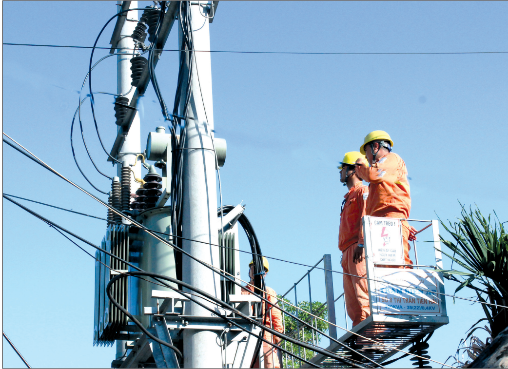
Công nhân Điện lực Tiến Hải kiểm tra trạm biến áp bảo đảm cấp điện an toàn, ổn định.
