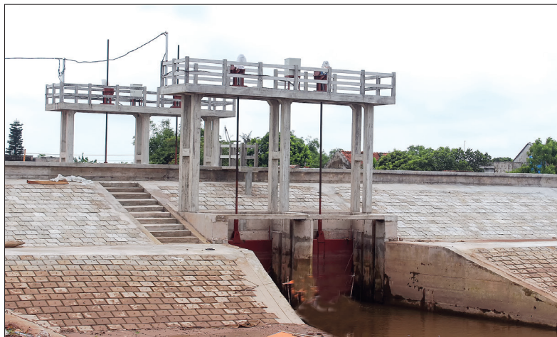
Cống Cá xã Đồng Trà được xây dựng bảo đảm tiêu ứng khi có mưa, bão xảy ra.
