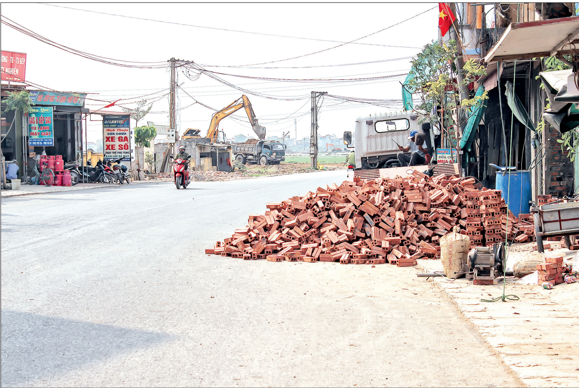
Ngang nhiên đổ gạch ra lòng đường, đoạn qua địa bàn xã Thụy Bình.
