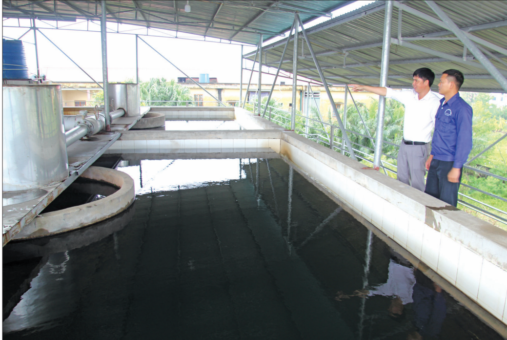
Bể lắng xử lý nước thô của nhà máy nước Đông Trung (Tiên Hải).
