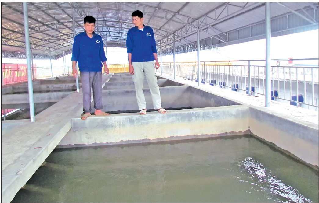
Hệ thống bể lọc nước sạch của nhà máy nước Long Hưng.
