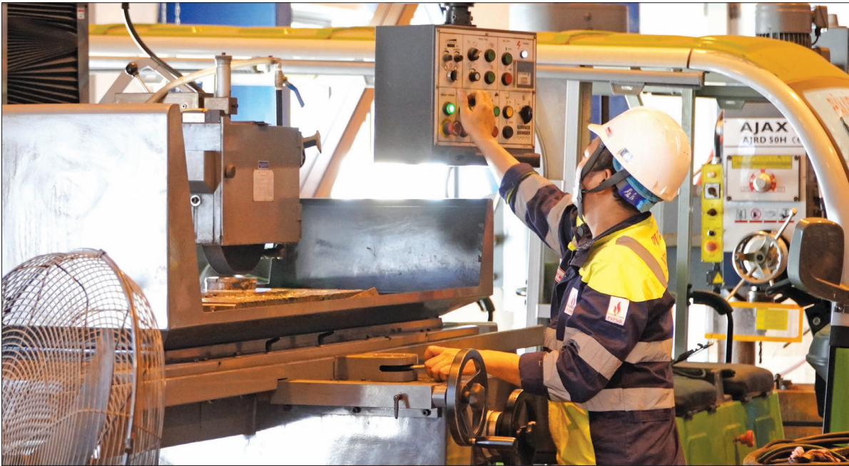
Công nhân phân xưởng bảo dưỡng, sửa chữa tập trung kiểm tra, xử lý bảo đảm cho các thiết bị, máy móc của Nhà máy nhiệt điện Thái Bình 2 hoạt động an toàn.
