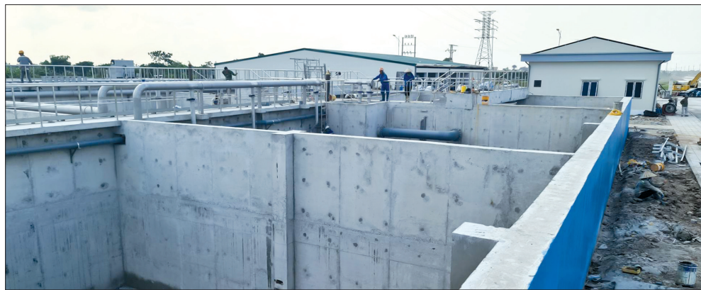
Nhà máy xử lý nước thải tập trung khu công nghiệp Liên Hà Thái giai đoạn 1 chuẩn bị hoàn thành đưa vào sử dụng.
