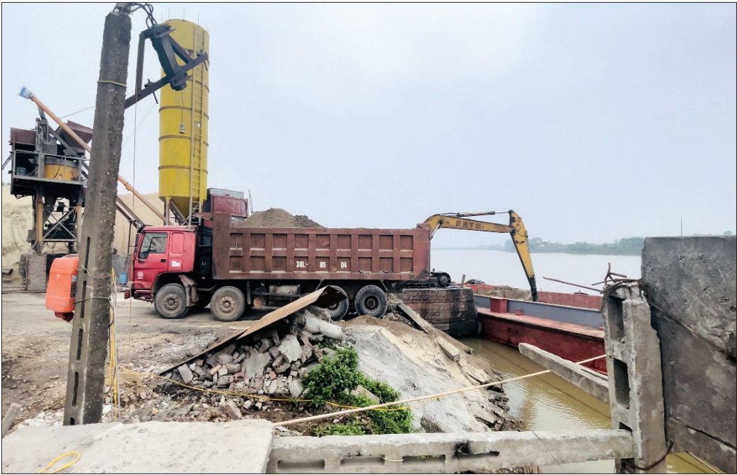
Công trình xây dựng trái phép của ông Phạm Văn Phong, thôn Tịnh Thủy, xã Hồng Minh (Hưng Hà).
