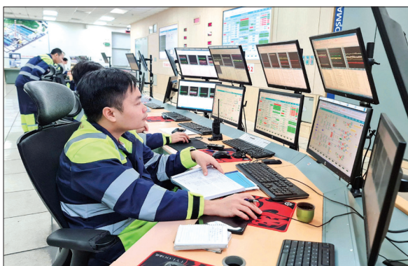
Các kỹ sư Nhà máy Nhiệt điện Thái Bình 2 vận hành hai tổ máy tại trung tâm điều khiển tự động.
