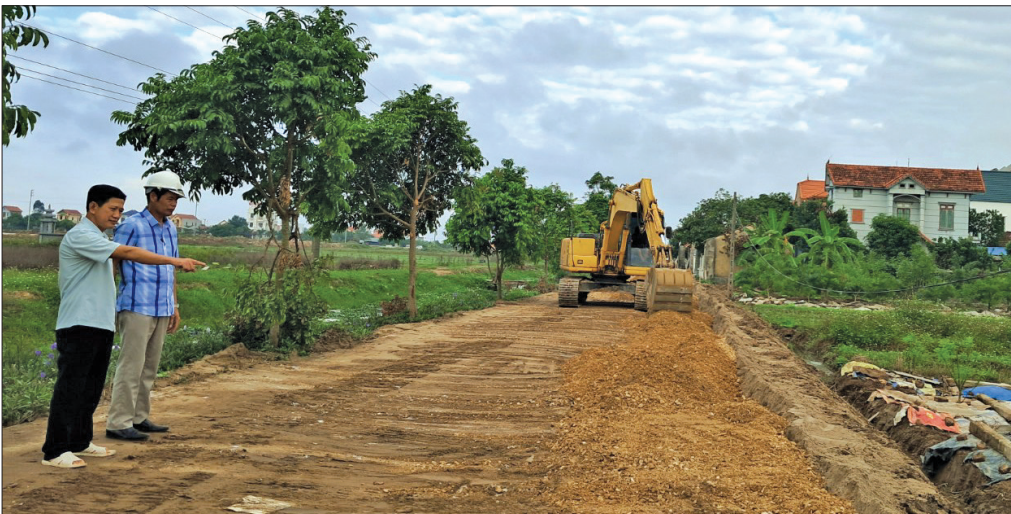
Xã Thụy Liên phấn đấu đến năm 2025 100% đường giao thông thôn, xóm được nâng cấp, mở rộng mặt đường 7m.
