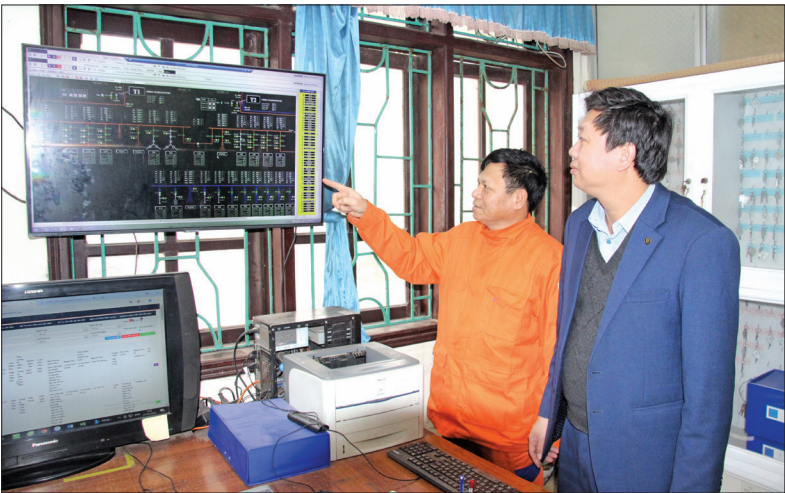
Điện lực Tiền Hải giám sát hệ thống lưới điện bằng phần mềm chuyên dụng, bảo đảm cấp điện an toàn, ổn định.
