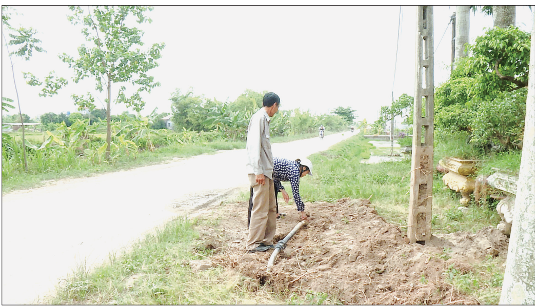
Đoạn đường ống dẫn nước bị thủng tại tuyến đường liên xã Đông Á - Đông Huy được nhà máy nước sạch Đông Huy dấu nối lại.
