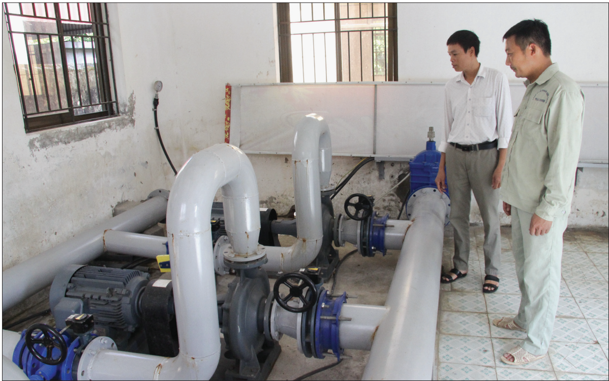
Công nhân Xí nghiệp nước Hưng Nhân kiểm tra hệ thống bơm.
