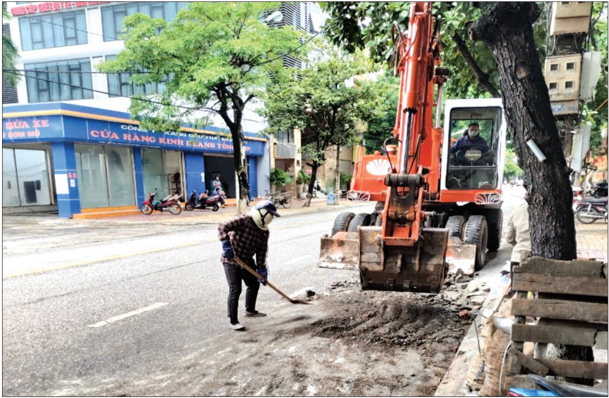
Phường Lê Hồng Phong thu gom lồi lên xuống chắn ngang rãnh thoát nước do người dân tại các tuyến phố tự ý làm.
