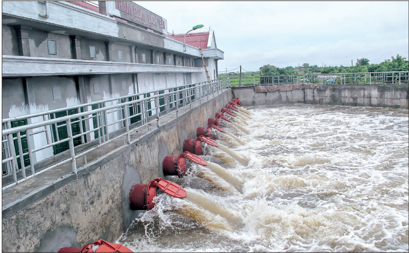
Trạm bơm Lịch Bài (Kiến Xương) vận hành hết công suất.
