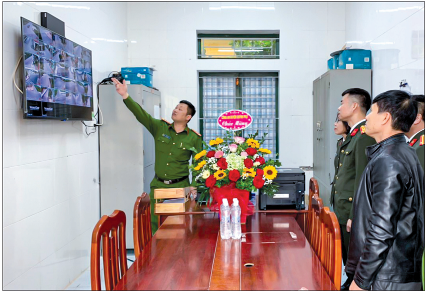
Hệ thống máy chủ của trung tâm chỉ huy đặt tại Công an xã.
