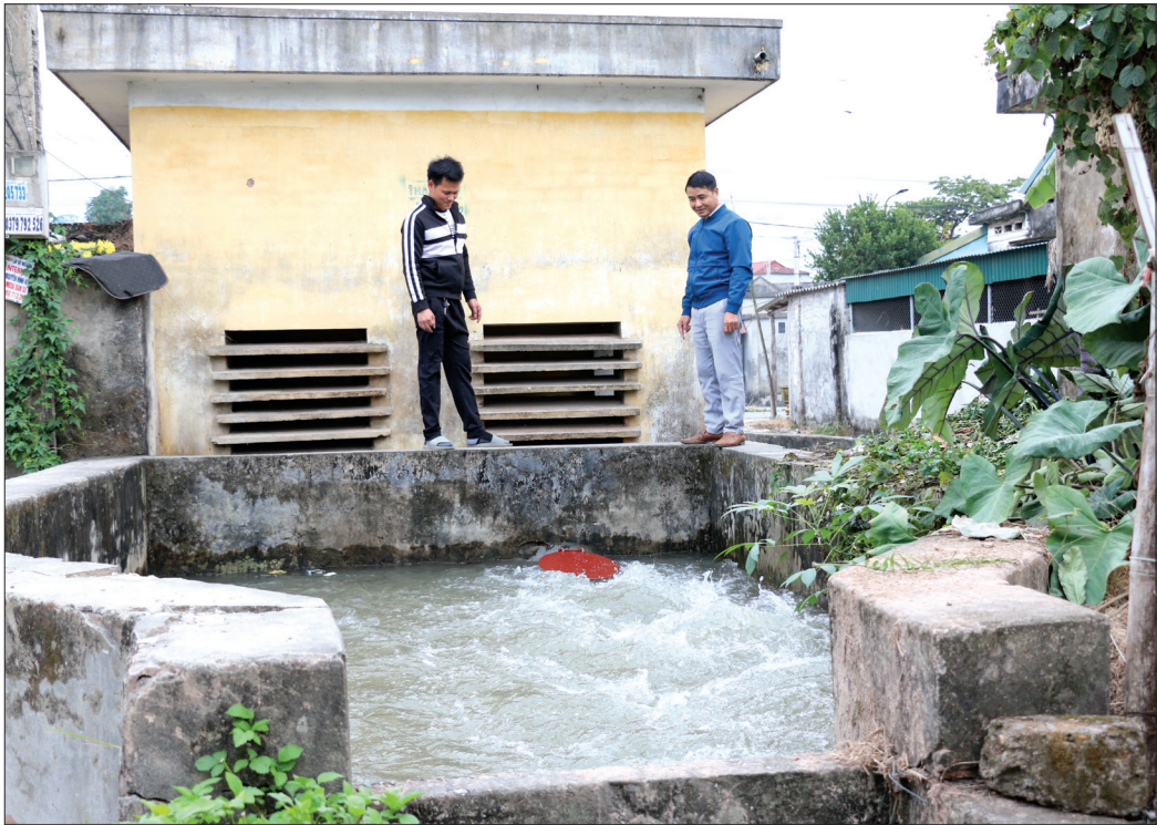
Trạm bơm số 1 Đồng Phú, xã Song Lãng (Vũ Thư) hoạt động hết công suất trong những ngày qua để bơm nước đổ ải phục vụ sản xuất vụ xuân.
