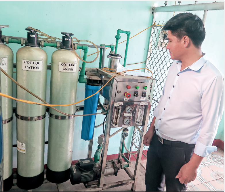
Giàn lọc nước RO đặt tại trụ sở UBND xã Bắc Hải.
