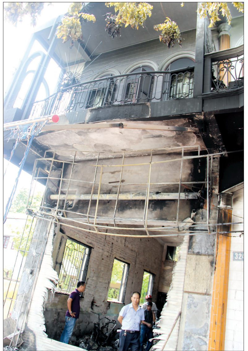
Vụ cháy xảy ra ngày 27/9/2015 tại số nhà 326, phố Lý Thường Kiệt, thành phố Thái Bình.
