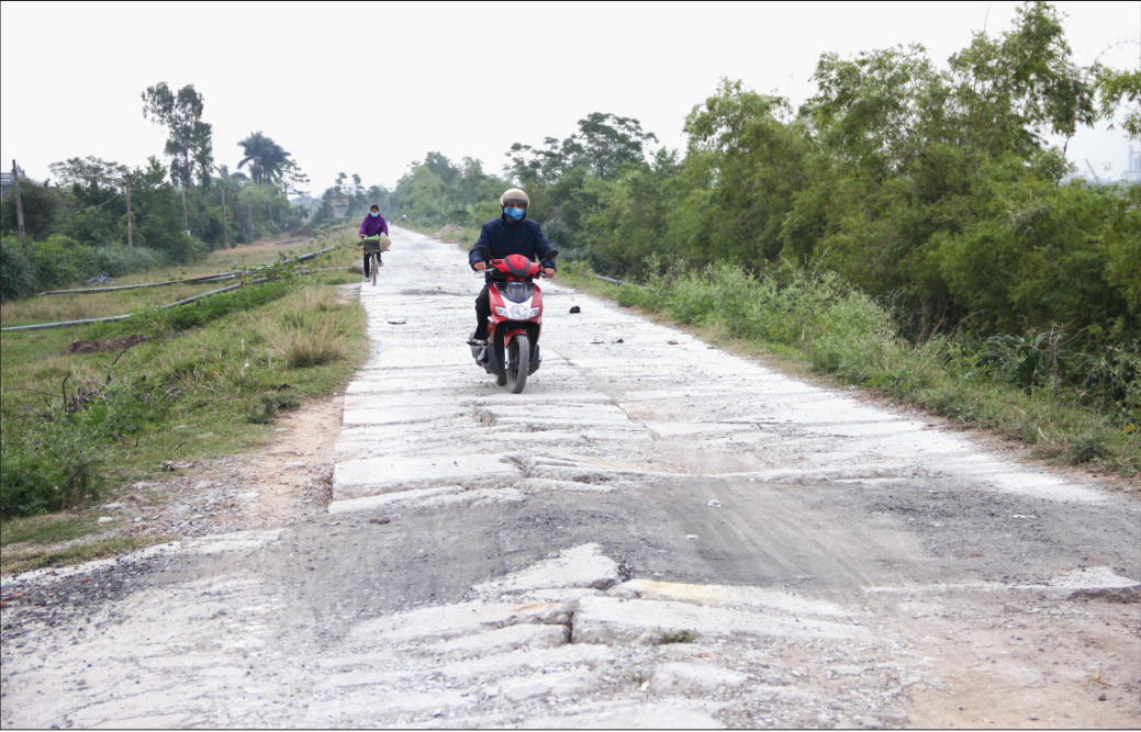
Mặt đê Trà Lý đoạn qua địa phận xã Đông Hòa (thành phố Thái Bình) xuống cấp nghiêm trọng do xe chở vật liệu xây dựng quá tải gây ra.
