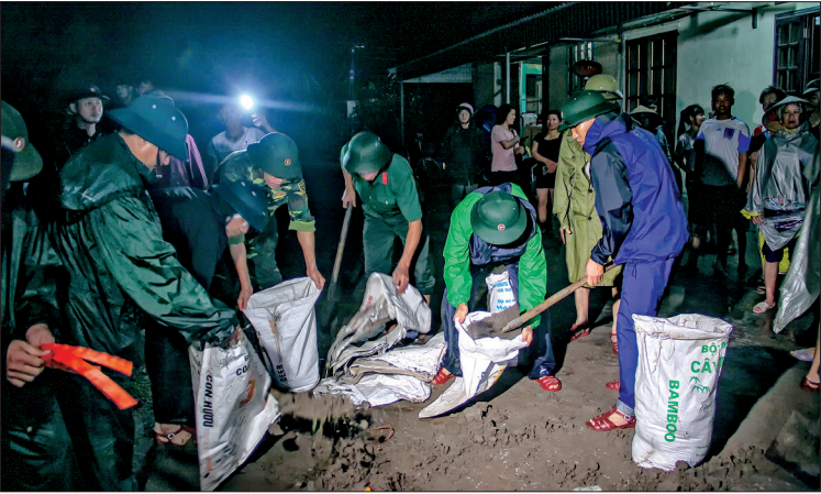
Các lực lượng xử lý sự cố mạch sủi tại cống Đò Cát, xã Vũ Văn (Vũ Thu) tối ngày 15/9.
