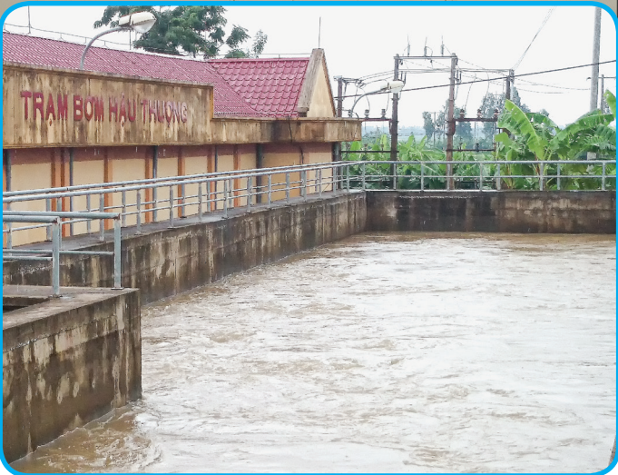
Trạm bơm Hậu Thượng (xã Bạch Đằng, huyện Đông Hưng) bơm tiêu nước chống ngập úng cho lúa các xã cụm I.
