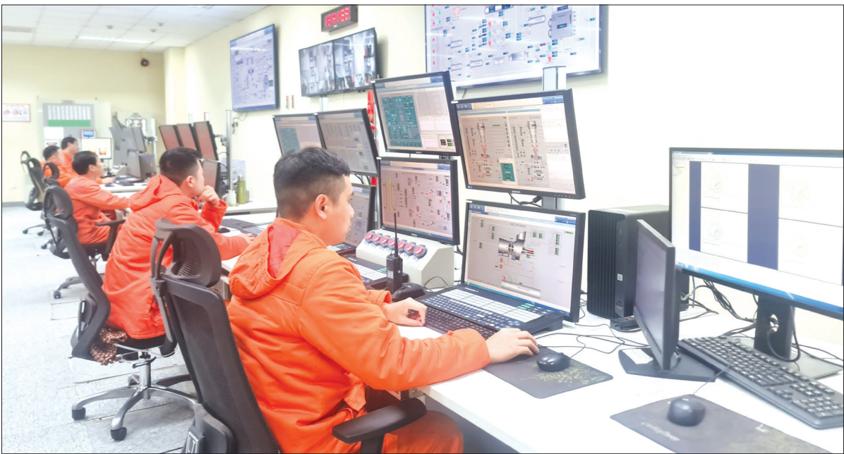
Đoàn viên, thanh niên có trình độ nghiệp vụ cao làm việc tại Trung tâm điều khiển tự động từ xa của Công ty Nhiệt điện Thái Bình.
