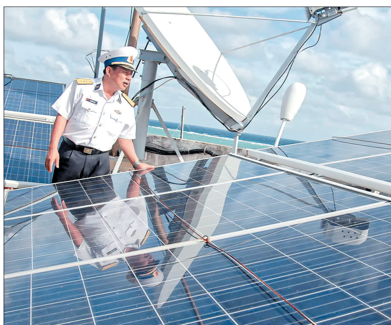
Những tấm pin năng lượng biến cái nắng chói chang trên biển thành nguồn điện sáng phục vụ đời sống của bộ đội Trường Sa.
