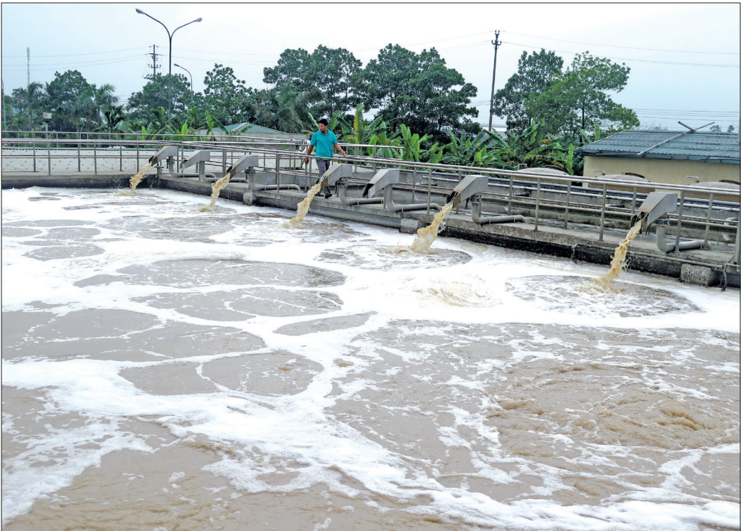
Hệ thống xử lý nước thải của Trung tâm Dịch vụ khu công nghiệp.
