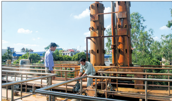
Công nhân Xí nghiệp nước sạch thị trấn Hưng Nhân vận hành hệ thống cấp nước.
