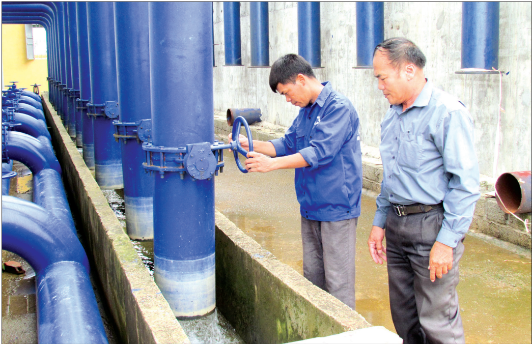
Kiểm tra vận hành bơm nước tại nhà máy nước sạch Long Hưng.
