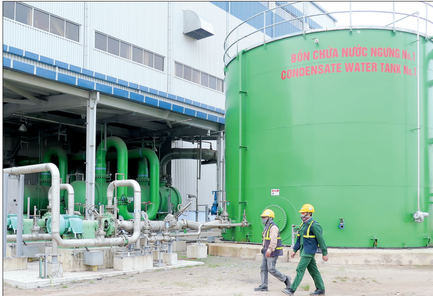
Nhà máy nhiệt điện Thái Bình.
