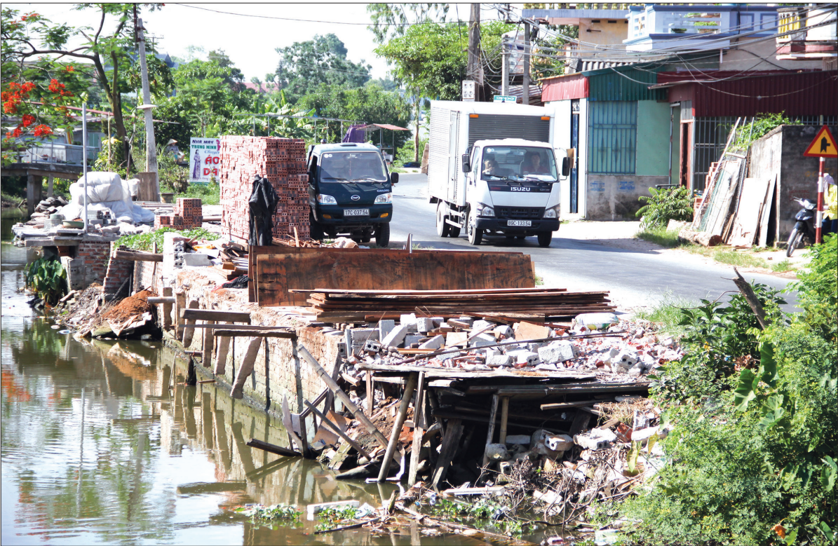
Một số vi phạm công trình thủy lợi trên địa bàn xã Minh Hòa (Hưng Hà) đã được xử lý nhưng chưa triệt để.
