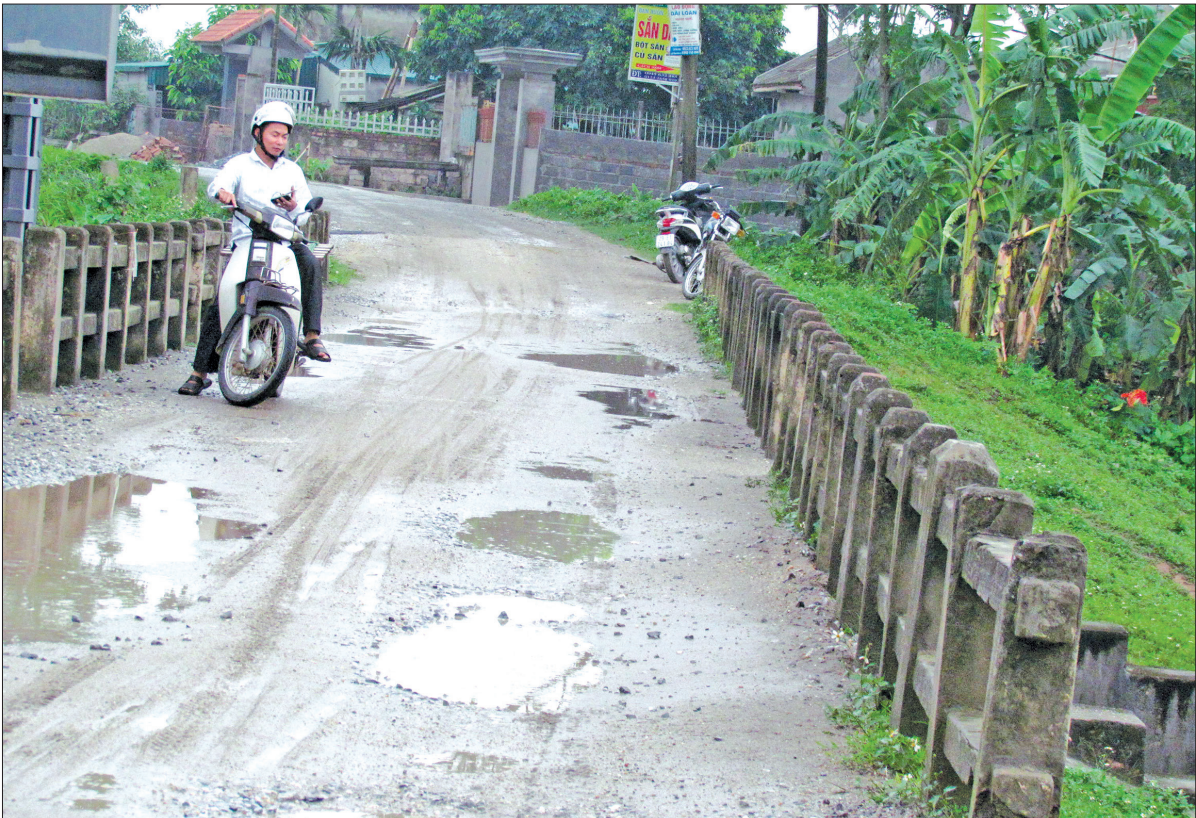
Mặt đê đoạn qua xã Tân Tiến (Hưng Hà) bị hư hỏng nhiều do xe tải trọng lớn chở vật liệu xây dựng thường xuyên chạy qua.
