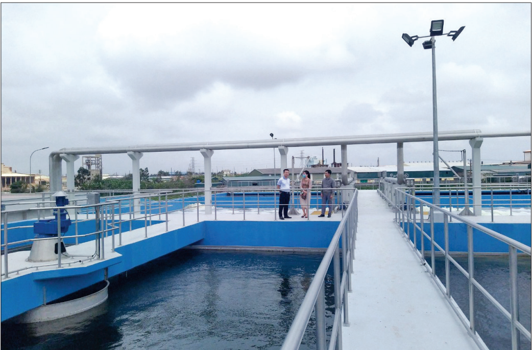
Trạm xử lý nước thải khu công nghiệp Tiến Hải được đầu tư hiện đại.
