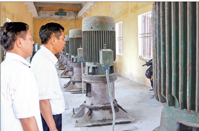
Kiểm tra hệ thống máy bơm phục vụ tưới, tiêu.
