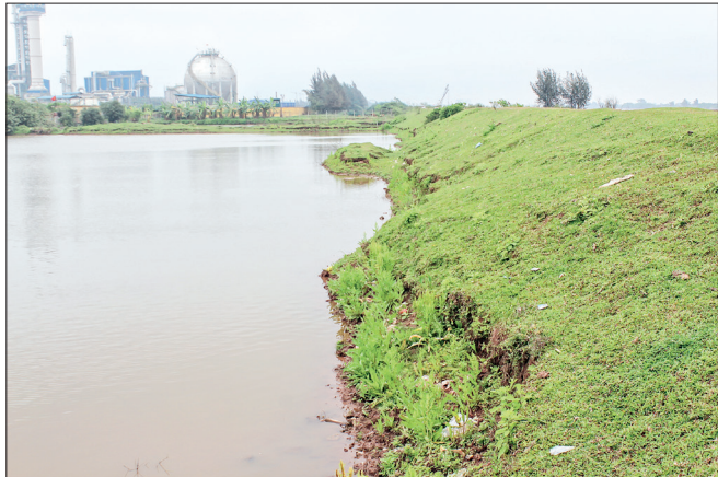
Hàng chục mét đê sông Trà Lý đoạn qua xã Thái Thọ bị sạt lở nghiêm trọng.
